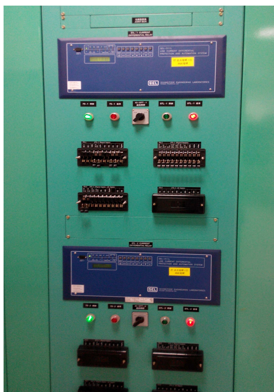
圖1 台電公司採購之161kV線路保護電驛
